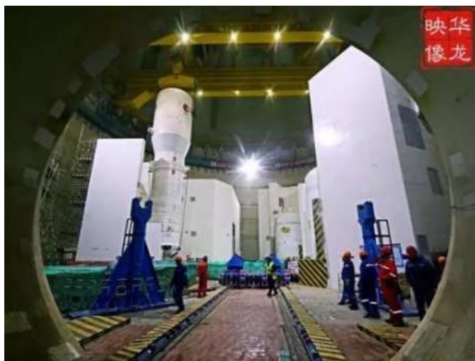
Instalace PG pro JE Fuqing 5 (Image: CNNC)
