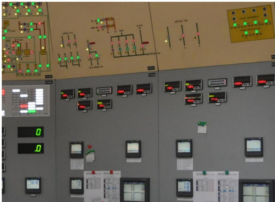
Část panelů BD se signalizací TVD
