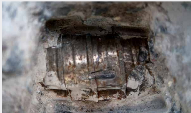
▲ Obr. 6 Detailní pohled na dodatečně předpjatý kabel K/9; trubka Sandrik prakticky bez známek koroze
