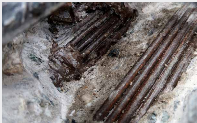
▼ Obr. 7 Detailní pohled na předpínací kabely v sondě I–J; u obou kabelů patrná povrchová koroze; kabel I–J/1 v místě sondy, proinjektováno
