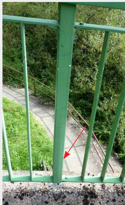
▼ Obr. 5 Typický příklad stejné poruchy odříznutého sloupku, deformace mohla nastat před opravou, ale i po ní, neboť mnohé oříznuté sloupky jsou zespodu uzavřeny navařených plechem
