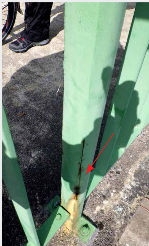
▼ Obr. 3 Příklad typické deformace a poruchy opraveného sloupku, bez možnosti odvodu kondenzátů z jeho dutého plechového profilu
